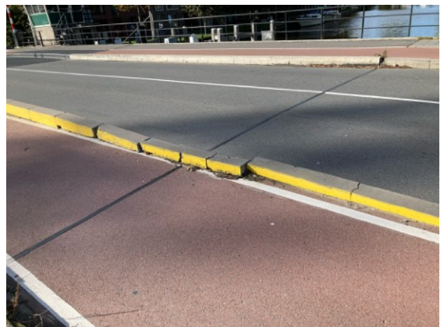
Beschadigde afscheidingsband op de Hoornse brug
